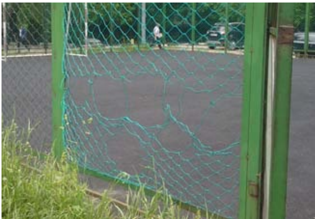
Улица 3-я Гражданская, дом 3. По всему периметру изорвана сетка ограждения
