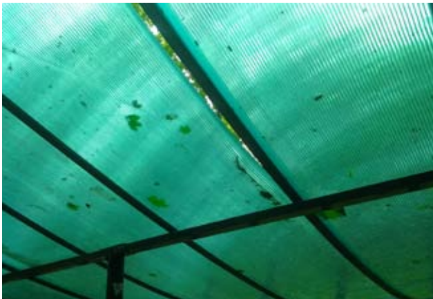
Улица Миллионная, дом 14. Поврежденная крыша площадки WorkOut
